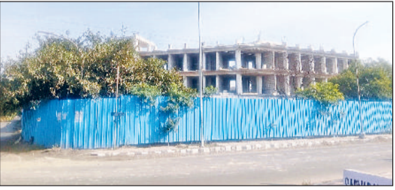
सोनीपत। मुरथल स्थित दीनबंधु छोटू राम विज्ञान एवं प्रौद्योगिकी विश्वविद्यालय में निर्माणाधीन आर्किटेक्चर विभाग का नया भवन।
